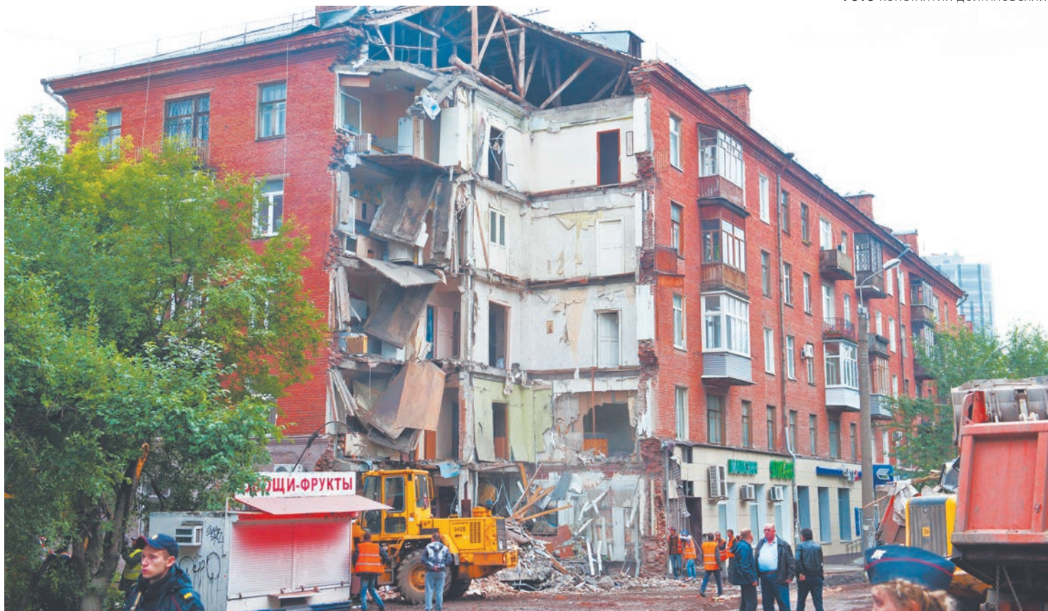
Дом на ул. Куйбышева, 103 после обрушения...
