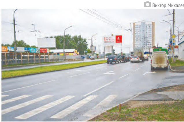
Подрядчик завершил ремонт участка на ул. Куфониной от ул. Подлесной до проспекта Паркового
