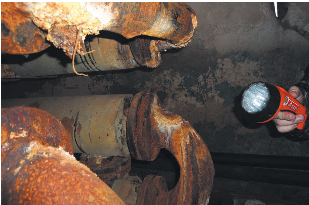
Неадекватное содержание инженерных коммуникаций дома может стать причиной для расторжения договора с управляющей компанией
